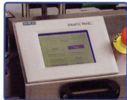
PLCコントロールタッチパネル (Synchroのみ)
